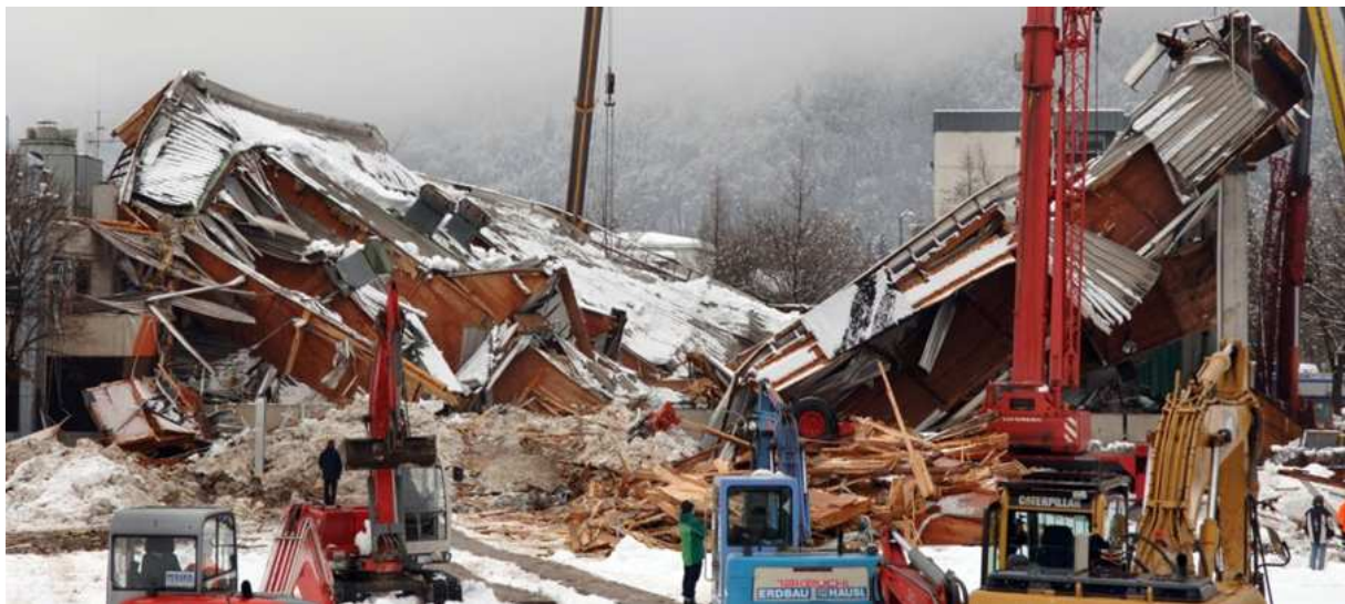
Die am 2. 1. 2006 vollständig „eingestürzte“ Eishalle in Bad Reichenhall.
